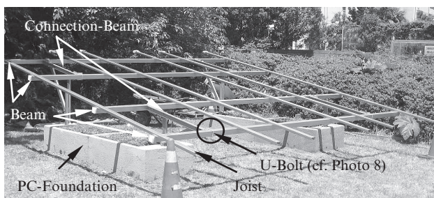
写真 6 「JFE ソーラーアレイ™」の骨組み構造 Photo 6 Framework of the "JFE Solar Array™"
